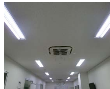
▲改用LED照明器具削减耗电量(千住技研)
